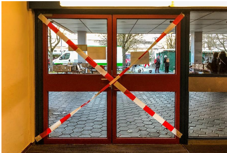
1 Defekte Eingangstür der neuen Mensa
